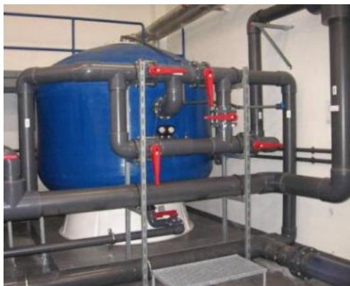
pískové filtry a rozvody vody
