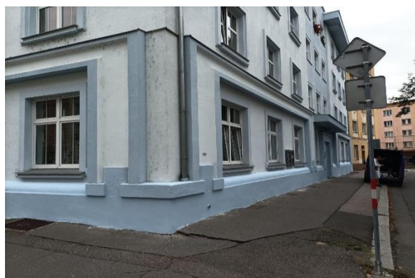
Sukovy sady 660, spodní část fasády a bytová jednotka číslo 27
